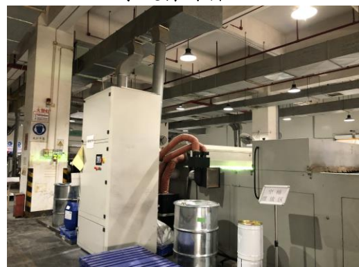
裝置位於印刷車間內
