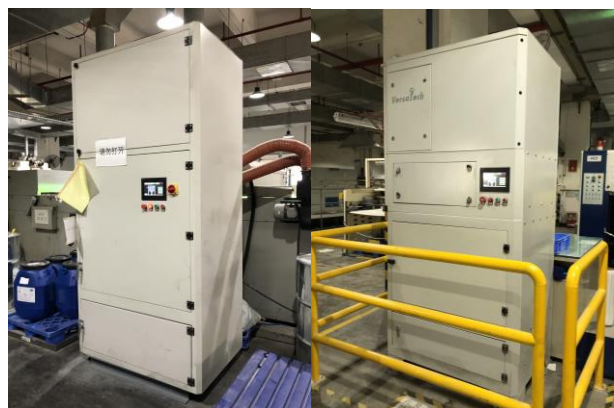
沸石吸附配合布袋過濾廢氣處理裝置
